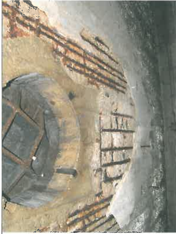
Zdj. nr 37 Kolejny przykład korozji betonu i stali w okolicy zsypu opatu. Widoczny wiaz żeliwny.
