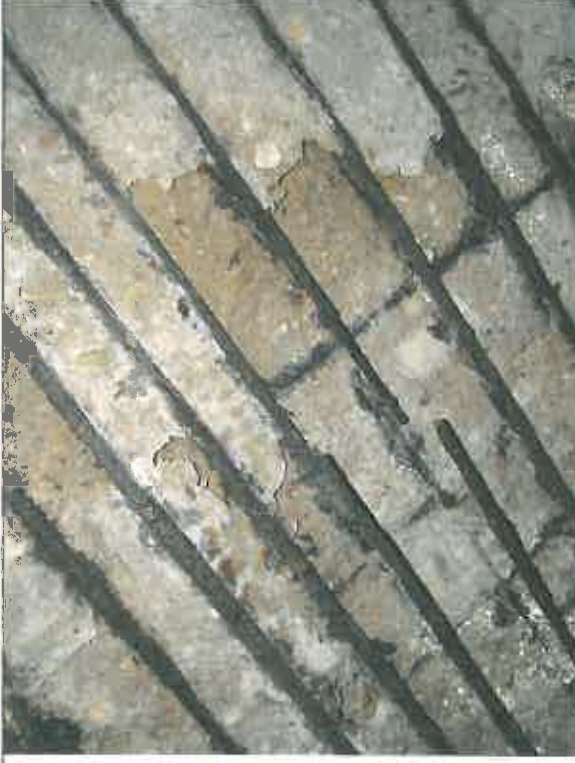
Zdj. nr 40 w miejscach dużych skorodowań widoczne pęknięte pręty przeżarte rdzą.
