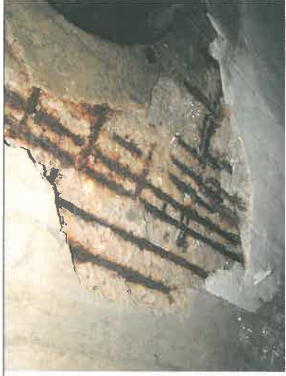
Zdj. nr 38 W niektórych miejscach przy zsybach opatu zbrojenie przestało pracować na skutek silnej korozji.
