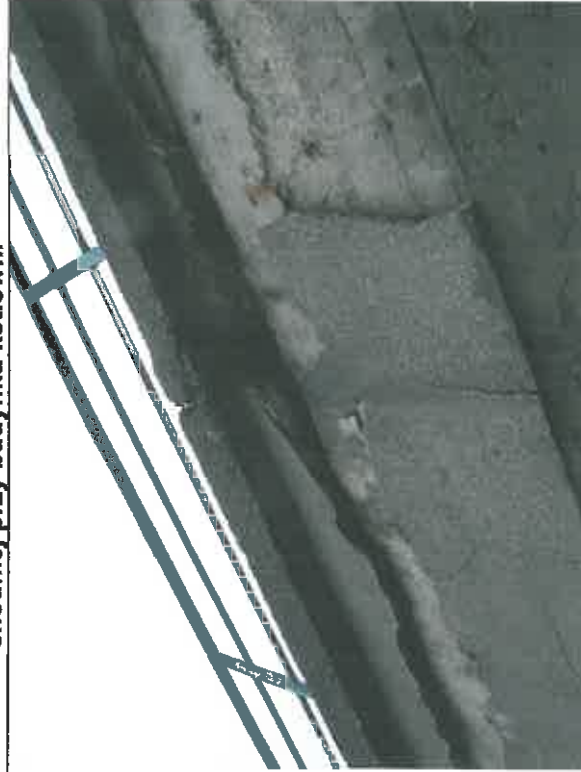
Zdj. nr 4 Ubytki i odspojenie tynku na wieńcu żelbetowym.
